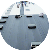
Sellados de techo
